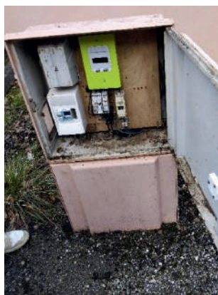
Armoire de Cde avant rénovation
